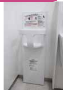
●ベビーチェア 全フロアの男女トイレに設置。
